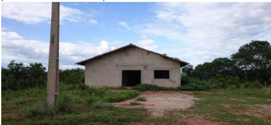
Figura 48 - Construção do Posto de Saúde para as Comunidades Quilombola-Kalunga: Limoeiro, Solidade, Ema, Abobreira, Diadema e Ribeirão. Obra interditada pelo Governo Federal- Município Teresina de Goiás/GO
