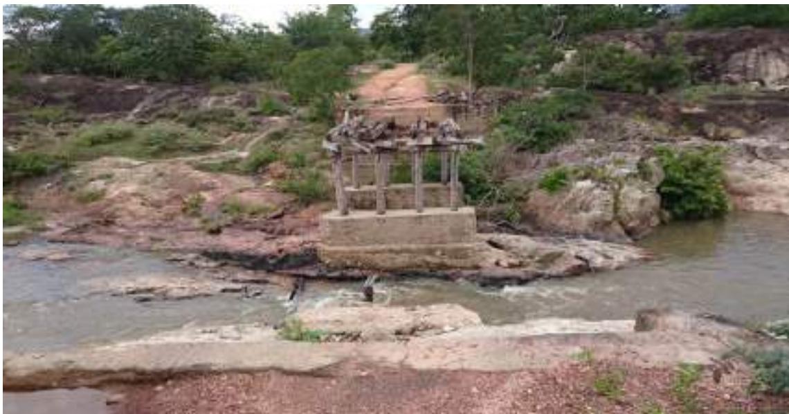
Figura 32 - Ponte interditada Quilombola-Kalunga -Teresina de Goiás/GO
