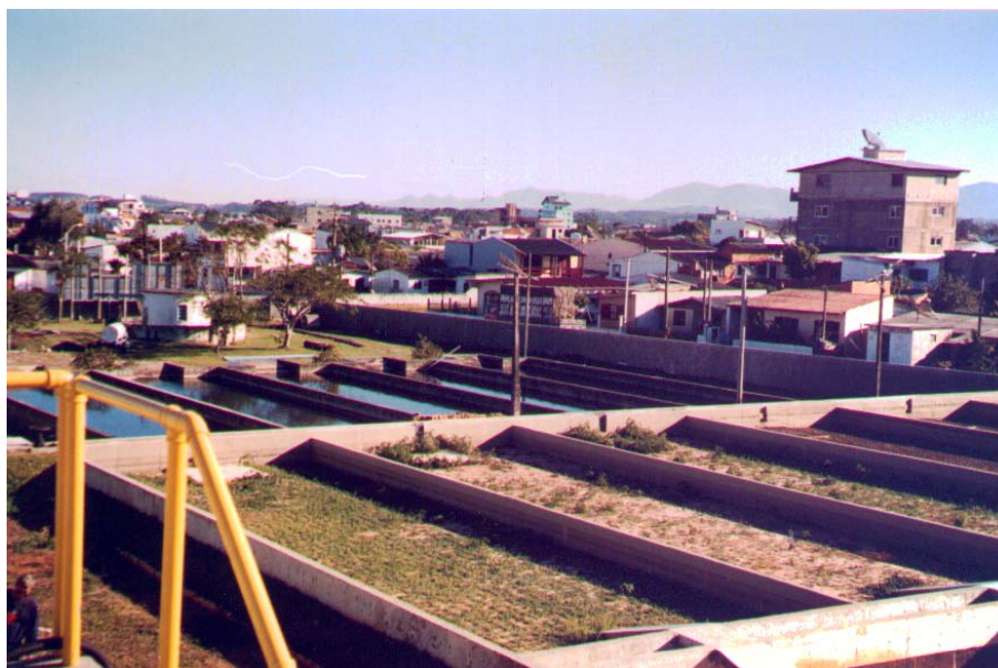
Foto 05 Estação de Tratamento de Esgotos de Torres
