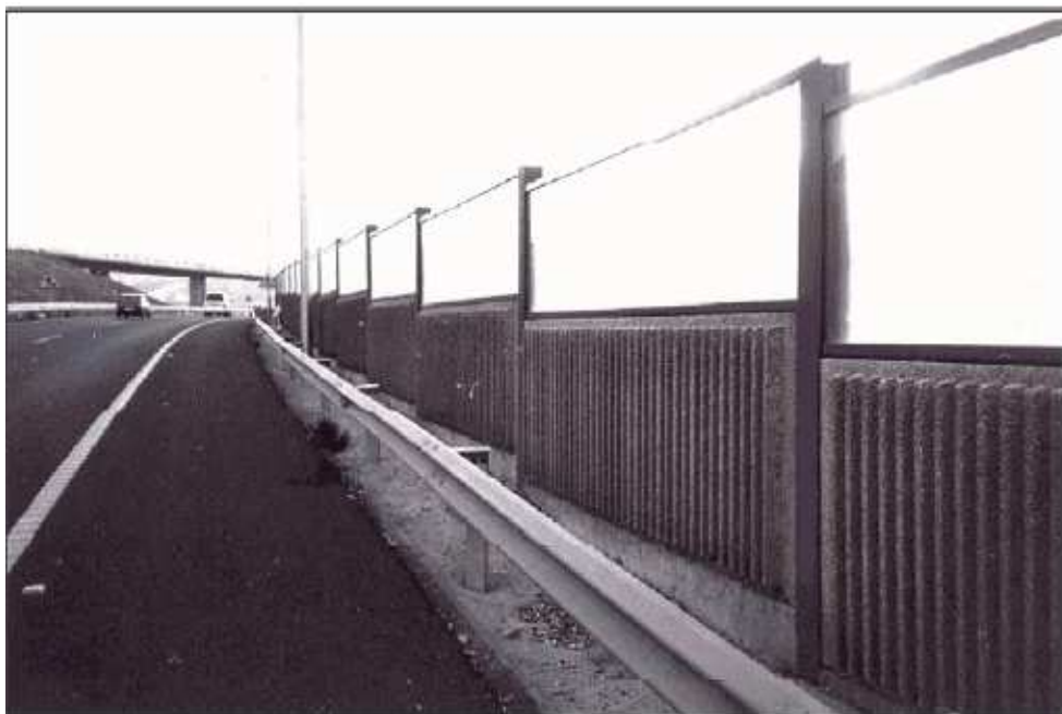
Pantalla con base de hormigón absorbente y elementos transparentes en la parte superior. Circunvalación de Las Palmas de G.C. (España)
