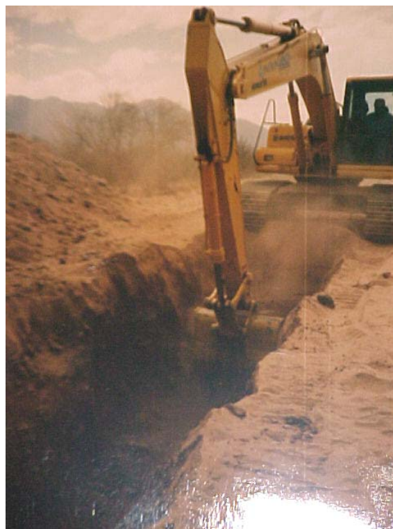
Foto 4.14 – Detalle de excavación de zanja con retroexcavadora (área de baja topografía relativa)
