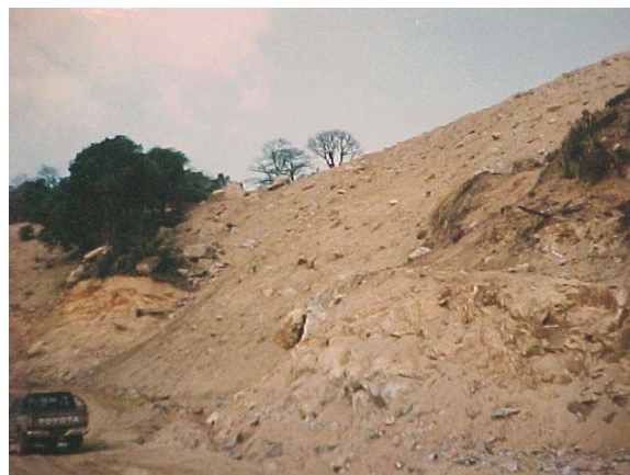
Foto 4.18 – Desplazamientos de suelo por ladera por nivelación y excavación para obra civil.
