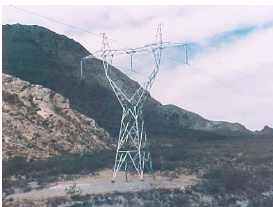
Foto 4.6 - Vista área de afectación superficial alrededor de la columna
